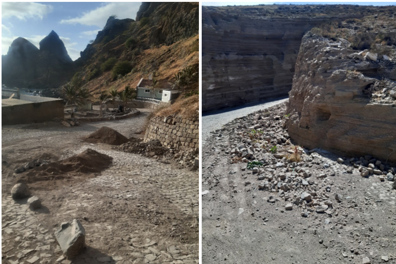
Figura 27: Acesso rodoviário a Fajã d'Água e vulnerabilidade das estradas. (Fotografia da equipa consultora, março 2024).
