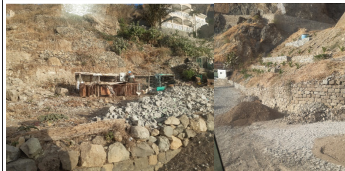
Construção em encostas com risco de movimentos de terra
